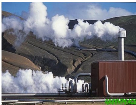
на фото: геотермальная теплоэлектростанция в Рейкьявике
